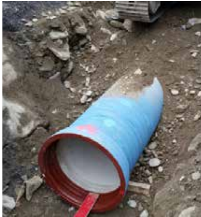
Die Druckleitungsrohre werden durch die Baumann Epp Bau AG, Bürglen und Arnold Heizung Sanitär AG, Schattordorf verlegt.
